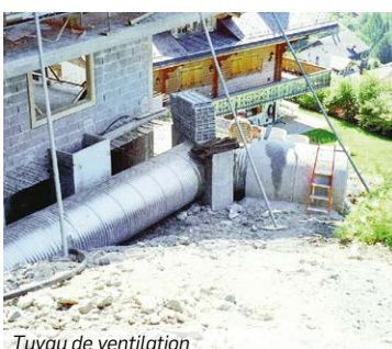
Tuyau de ventilation
