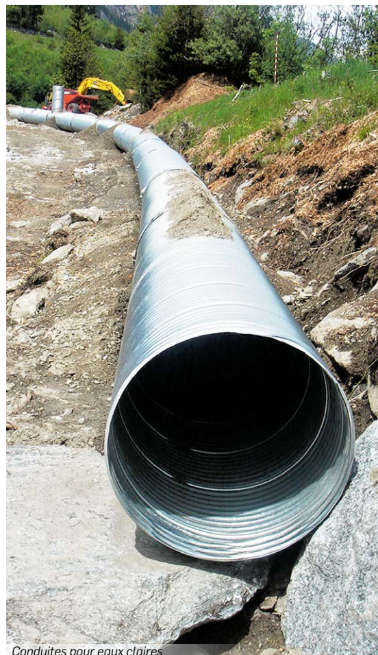
Conduites pour eaux claires
