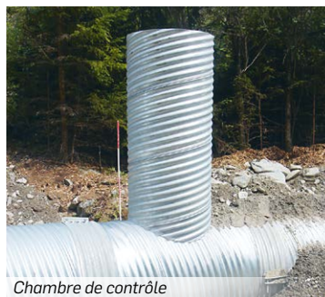
Chambre de contrôle
