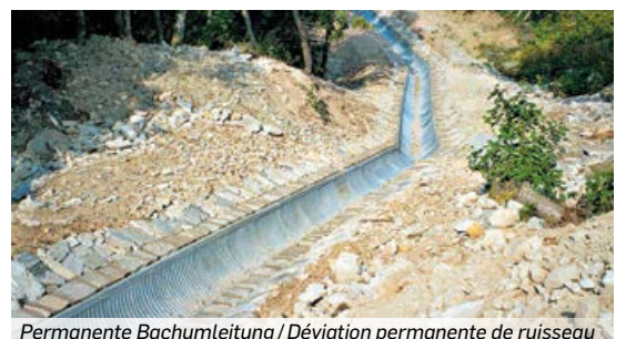
Permanente Bachumleitung / Déviation permanente de ruisseau
