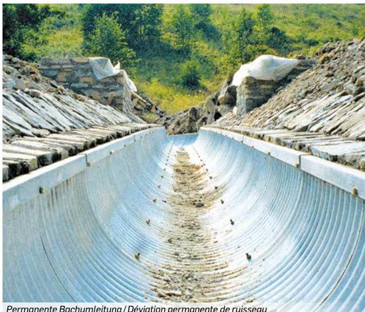
Permanente Bachumleitung / Déviation permanente de ruisseau
