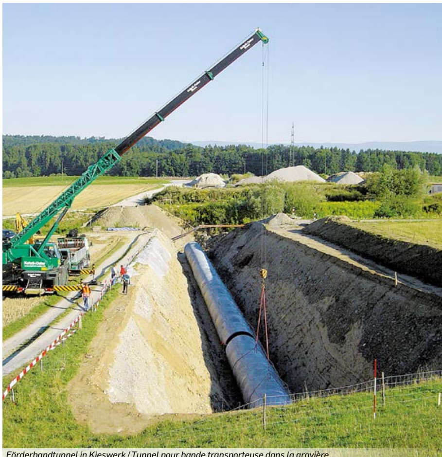
Förderbandtunnel in Kieswerk / Tunnel pour bande transporteuse dans la gravière
