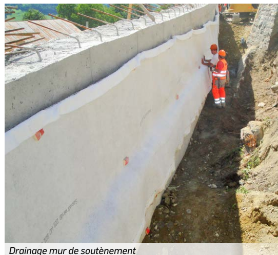
Drainage mur de soutènement
