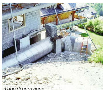
Tubo di aerazione
